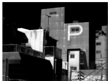
サイディングボード壁漏水
